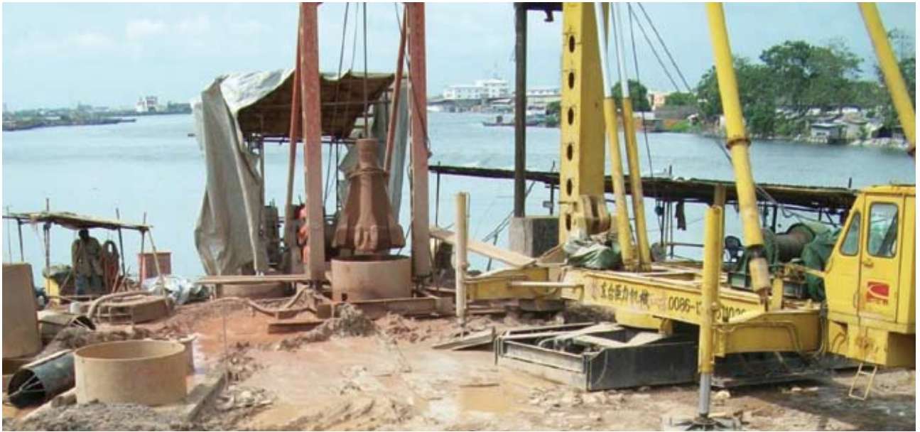
השיטה הסינית להחדרת כלונסאות לקרקע, באמצעות משקולת כבדה המונחת על הכלונס דרך צינור מגן
